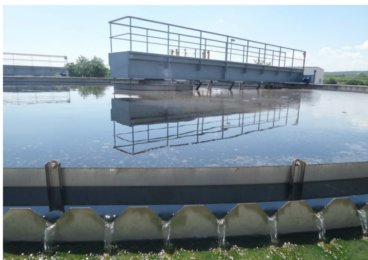
Un impianto di depurazione dell'Acquedotto Pugliese
